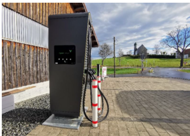
Stacja ładowania DC zamontowana na fundamencie z poliwęglanu z ocynkowaną ogniowo płytą adaptacyjną
