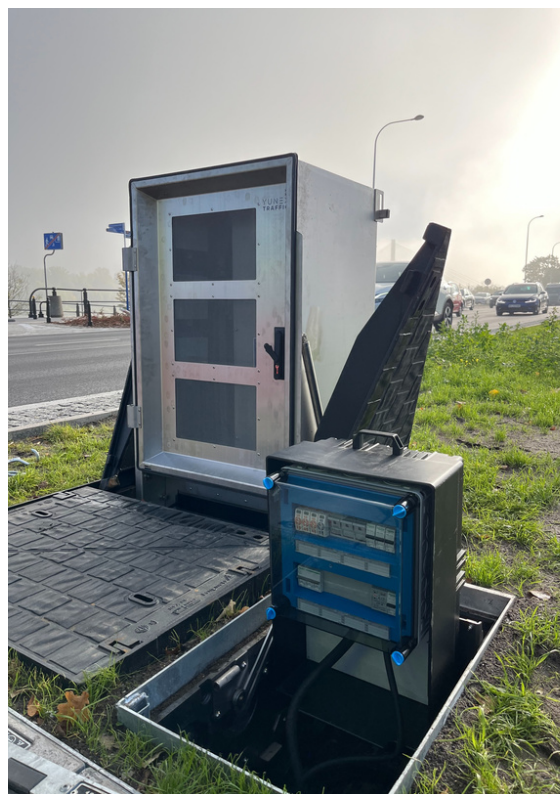
Szafa chowana w studni ze sterownikiem sygnalizacji świetlnej oraz systemem zabezpieczeń w rozdzielnic EK 510 flx
