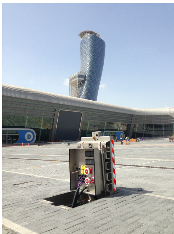
Rozdzielnica chowana w studni
